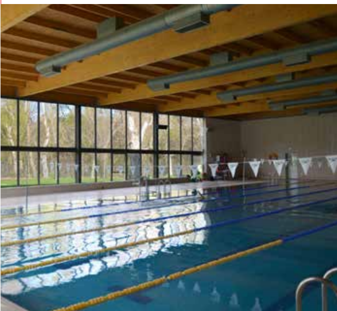
Piscinas Municipais (Barcelos) Sistema instalado: Sistemas de desumidificação gama DanX
